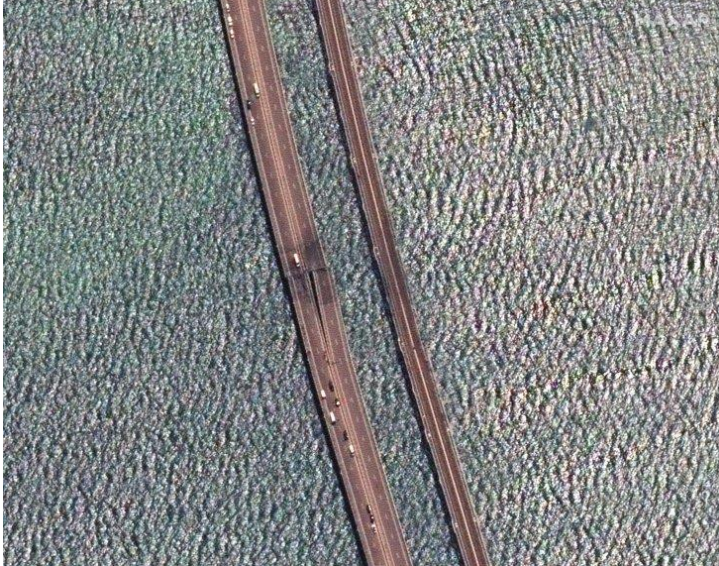
Satellietopname van de Krimbrug. In het midden een beschadigd weggedeelte door een Oekraïense drone-aanval.- beeld ANP
